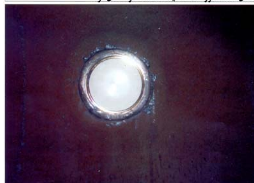
شکل ۱۱: سنسور فلات دیده شده در داخل لوله
